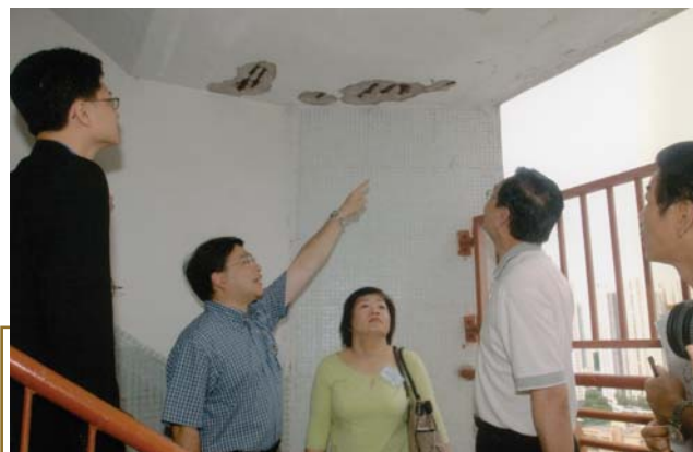
立法會議員視察竹園北邨其中一座樓宇的維修問題。竹園北邨是按房屋委員會租者置其屋計劃出售的屋邨，房屋委員會為該些樓宇提供7年樓宇結構安全保證。
